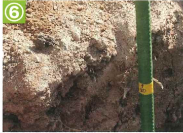
⑥ S.シート+の埋設深である50cmを確認しつつ進める。
